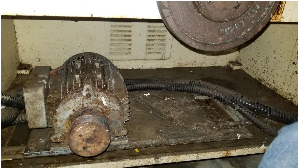
Ilustración 21: Motor después de la inundación
