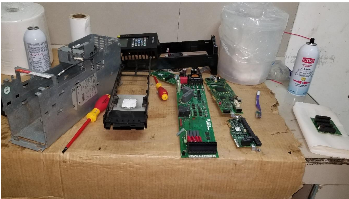
Ilustración 24: Variador de frecuencia desarmado
