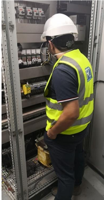
Ilustración 9 Pruebas de breakers de circuitos Fuente: Propia
