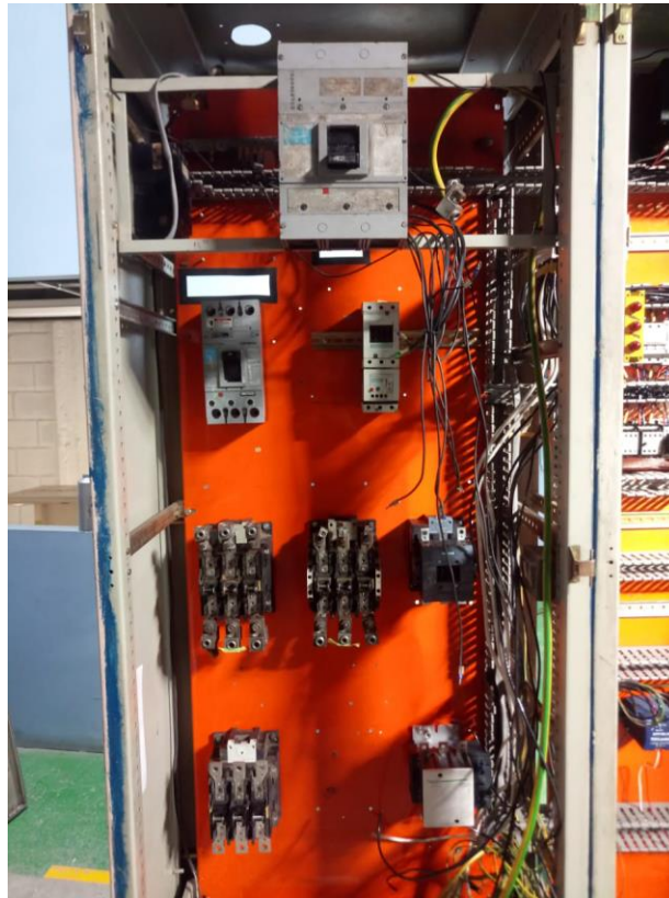
Ilustración 34. Panel de control de potencia
