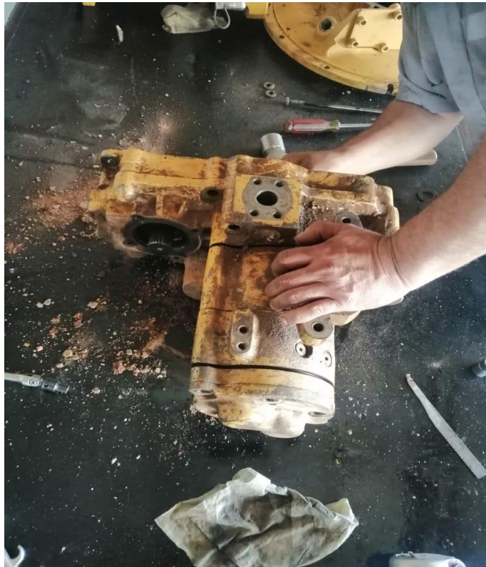
Ilustración 88: Bomba lista para ser desarmada
