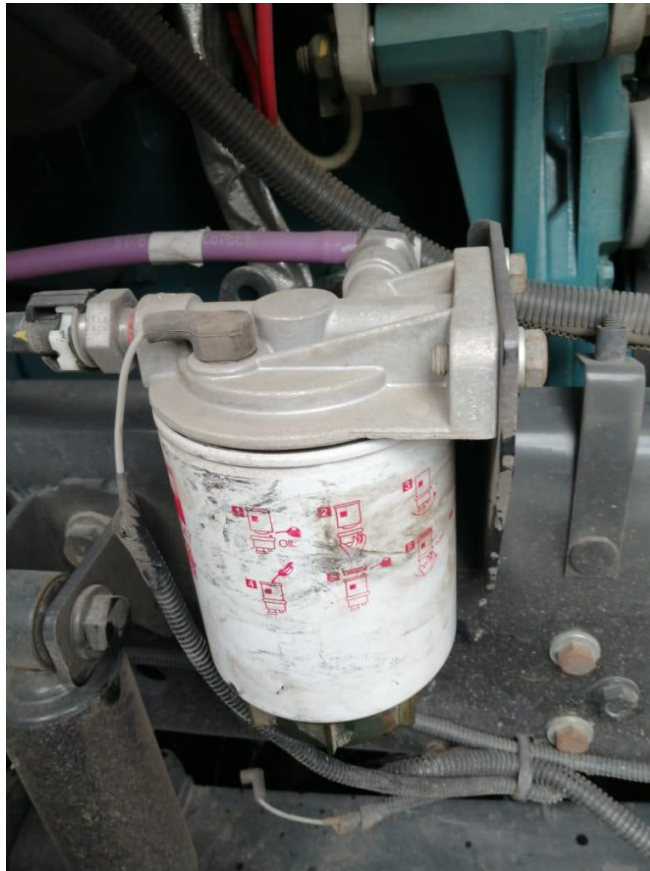
Ilustración 101: Cambio de filtro separador de diesel y agua en el sistema
