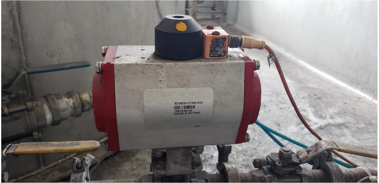
Ilustración 20 Actuador neumático para apertura y cierre de válvulas
