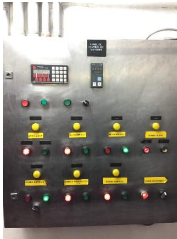
Ilustración 1. Panel de Control de los tanques de llenado en Lacthosa.
