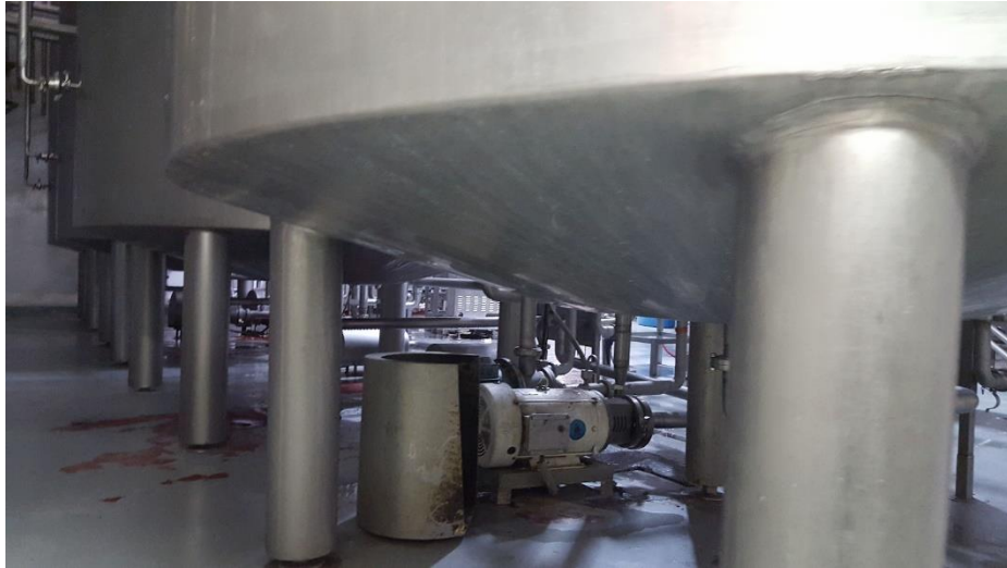
Ilustración 17. Parte Inferior de los tanques de llenado sin ninguna automatización.
