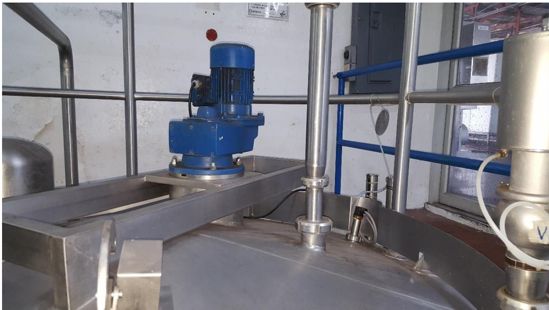
Ilustración 20. Instalación de los sensores de nivel máximo
