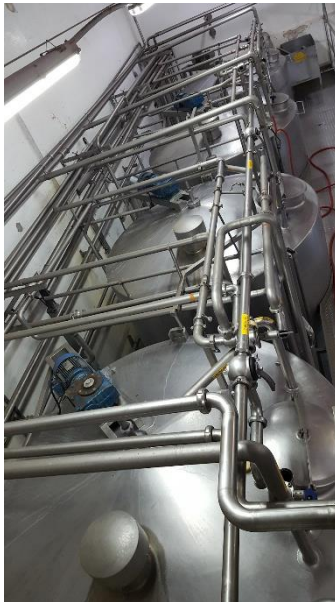
Ilustración 16. Parte Superior de los tanques de llenado sin ninguna automatización.
