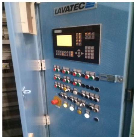
Ilustración 35. Panel Eléctrico de la secadora LAVATEC
