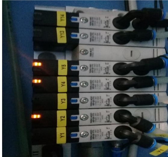
Ilustración 11. Conjunto de Electroválvulas
