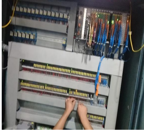
Ilustración 32. Panel Eléctrico de secadora
