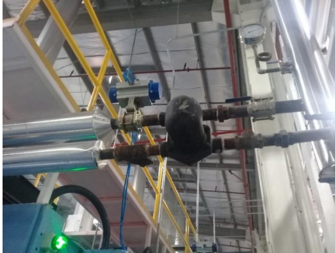
Ilustración 14. Sistema de Vapor para secadora LAVATEC
