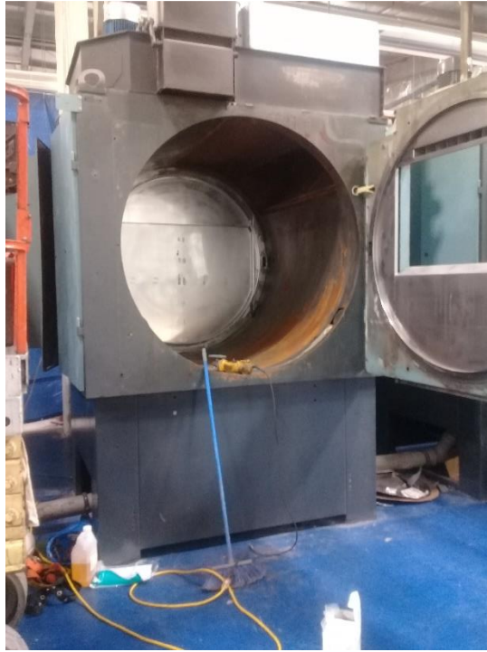
Ilustración 45. Vista General de la Secadora
