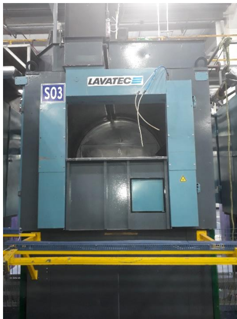
Ilustración 26. Instalación de la secadora LAVATEC
