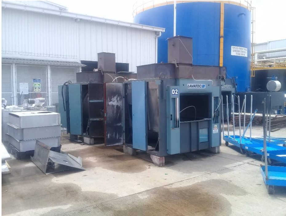
Ilustración 47. Secadoras antes de la instalación
