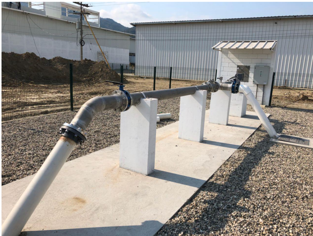
Anexo 3: Tren de descarga nuevo en acero inoxidable
