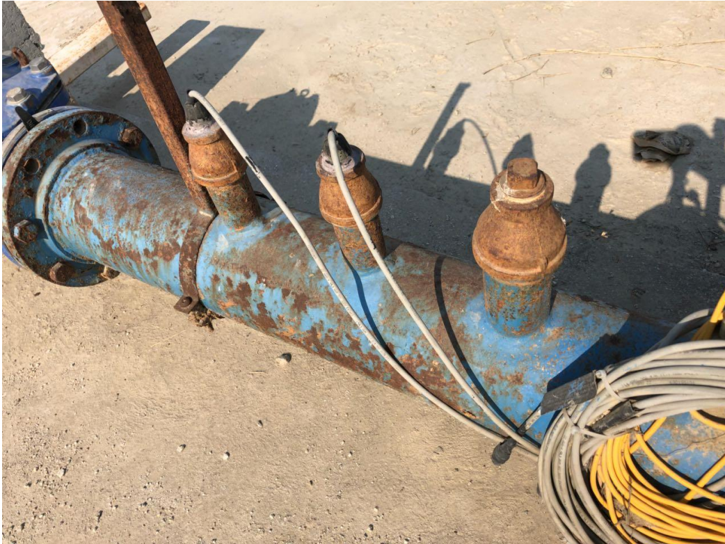
Anexo 4: Carrete para sensores en tren de descarga viejo
