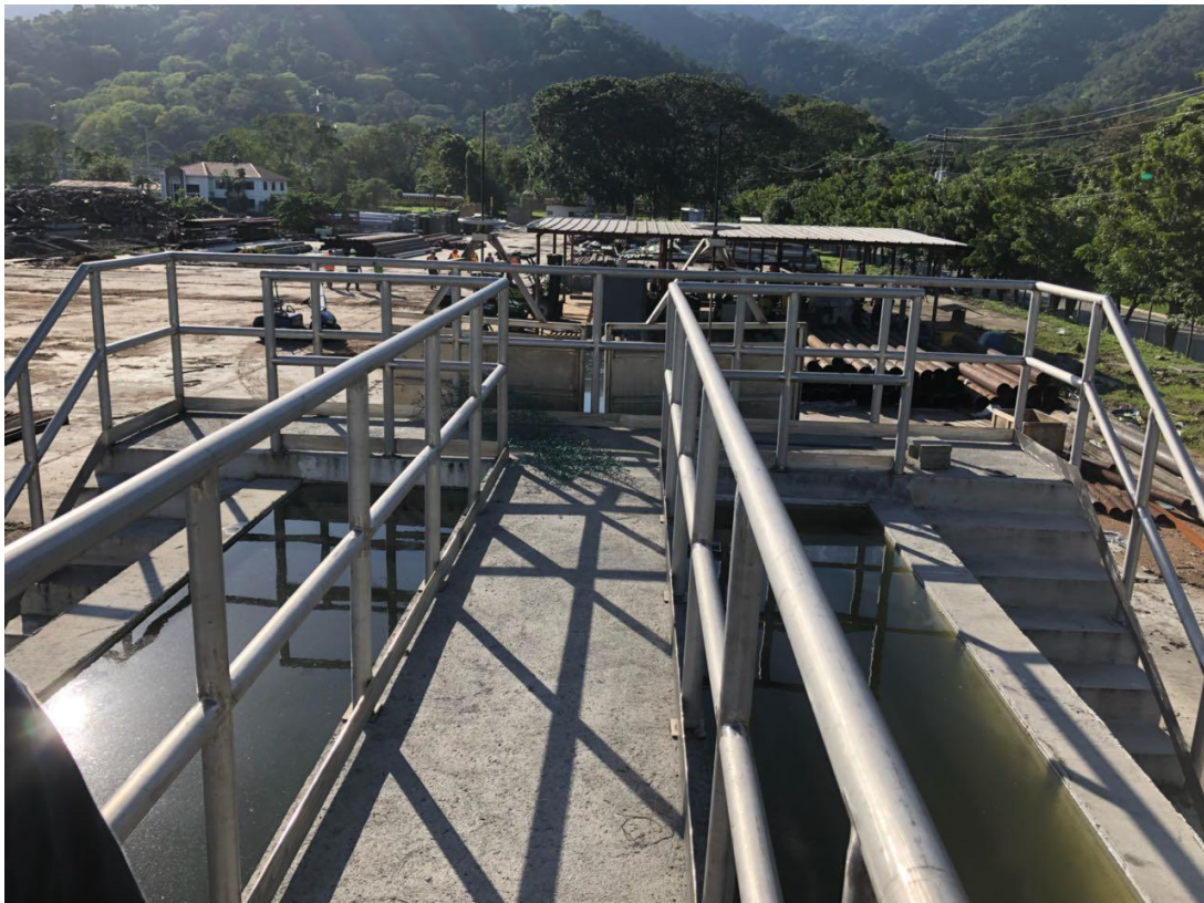
Anexo 7: Vista Superior de decantador de Fase I
