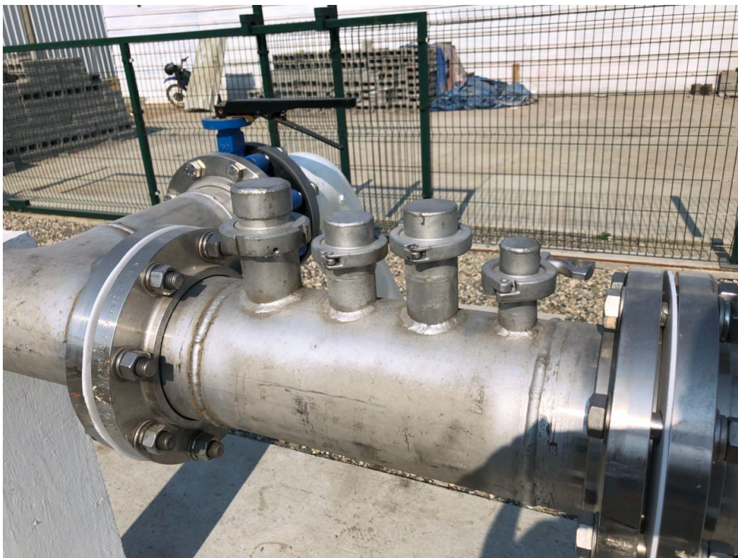
Anexo 5: Carrete para sensores nuevo en tren de descarga de acero inoxidable
