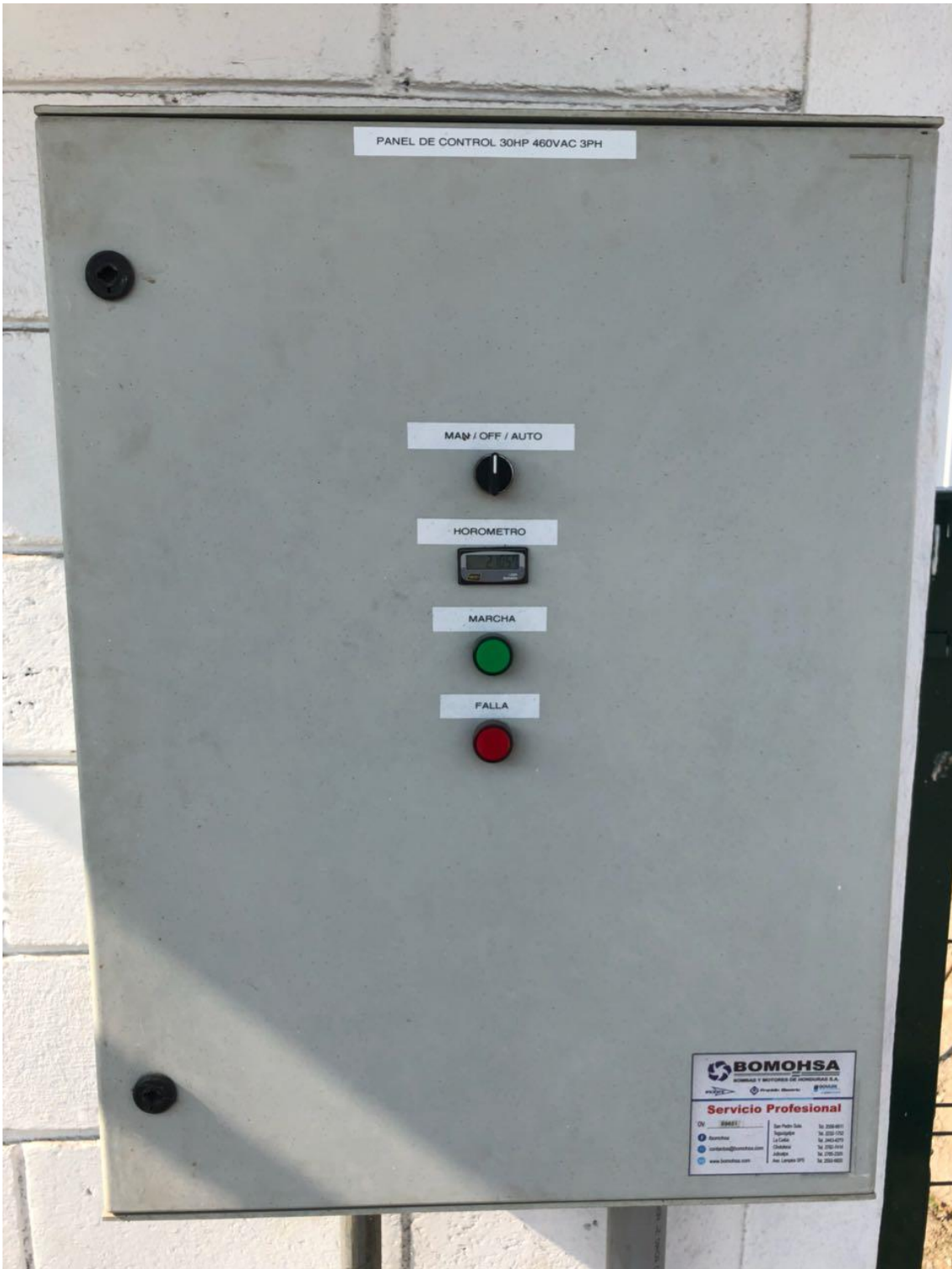
Anexo 6: Panel de Control para pozos nuevos de Sulatex
