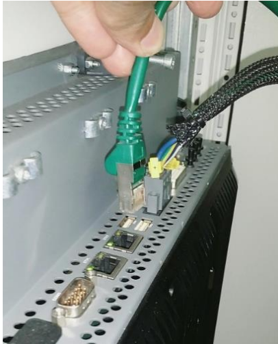
Ilustración 16: Desconexión del cable ethernet de la pantalla HMI
