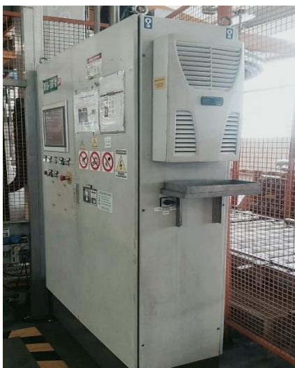
Ilustración 21: Panel eléctrico de la envolvente
