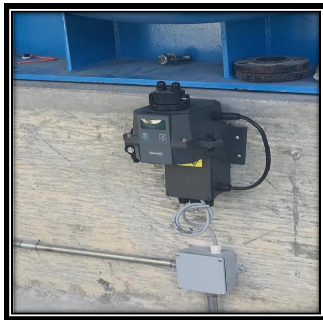
Ilustración 34. Sensor de Turbidez Planta de Tratamiento, ASP
