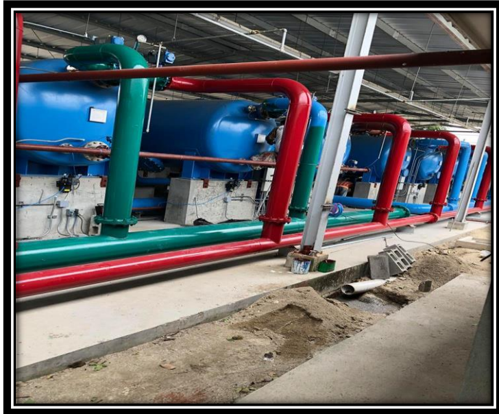
Ilustración 35 Tanques de Filtración.
