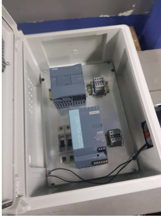
Anexo 3_Montaje Interior Gabinete
