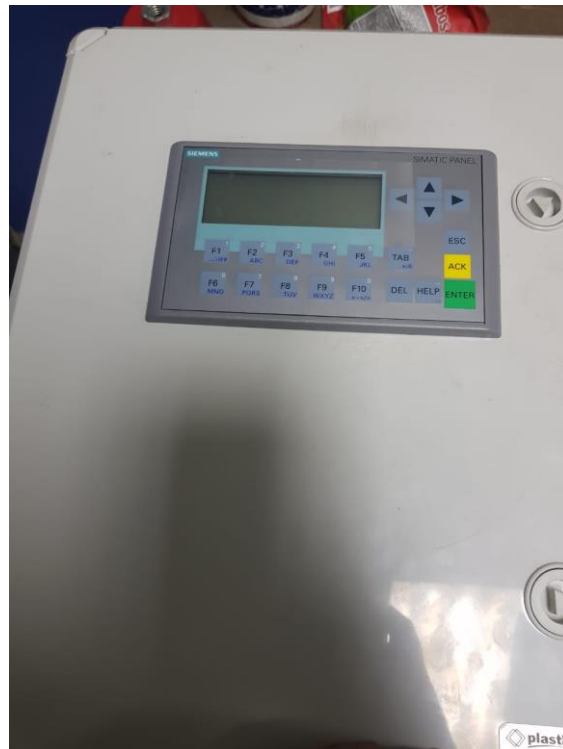
Anexo 1_ Montaje HMI
