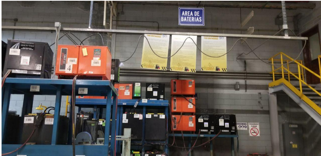
Anexo 9. Área de Baterías y Cargadores Industriales
