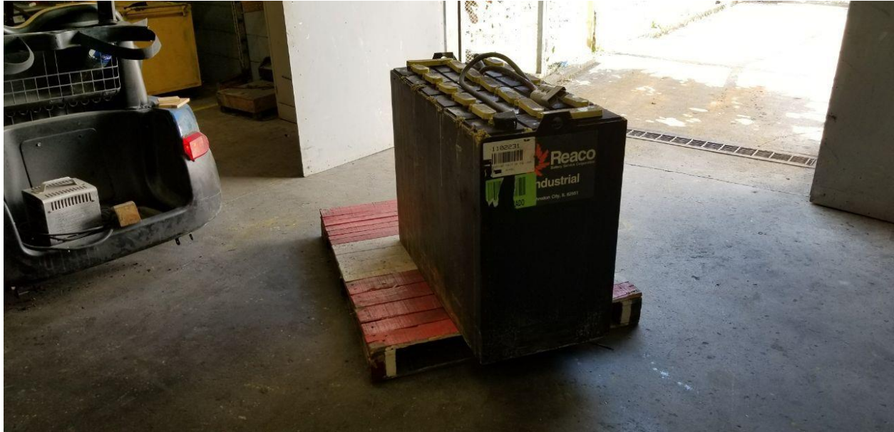
Anexo 10. Batería Industrial de 48 V DC
