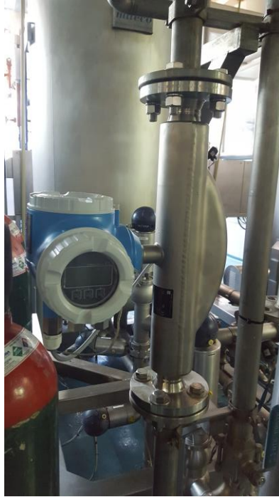
Ilustración 9 - Medidor de flujo con desperfecto de fábrica
