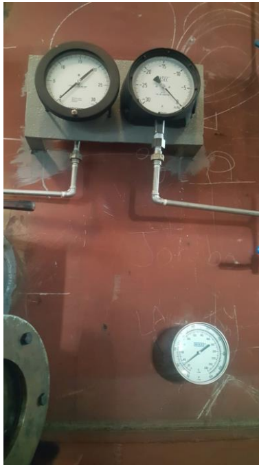
Ilustración 49 Manómetros y Termómetros
