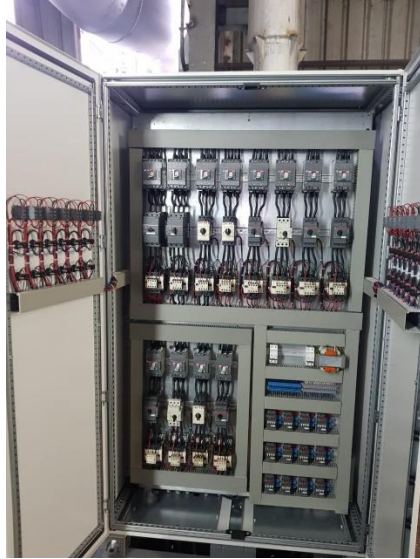
Ilustración 45 Panel de control eléctrico
