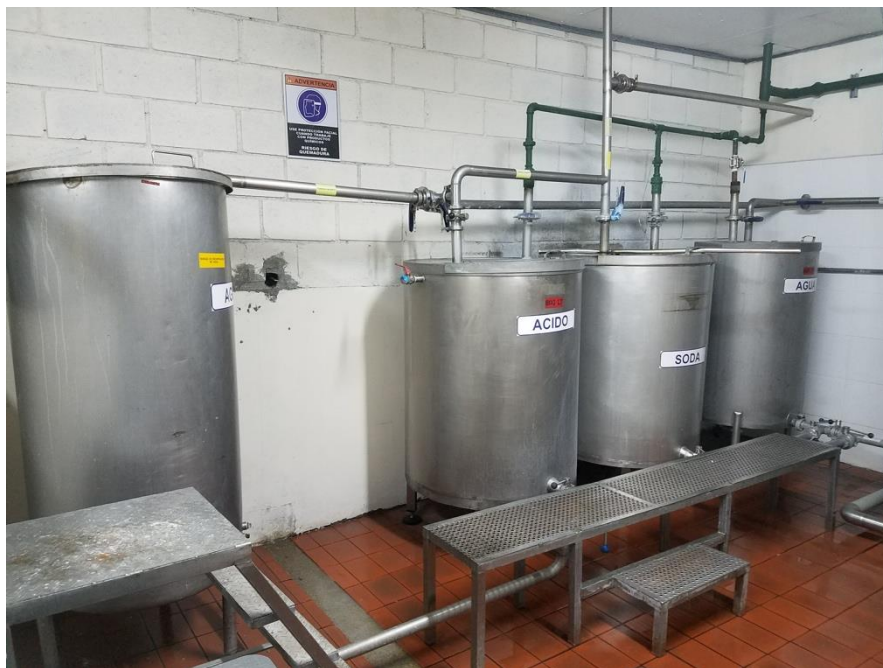
Ilustración 6. Tanques de quimicos
