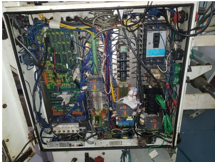
Ilustración 4: Panel de control de maquina empacadora
