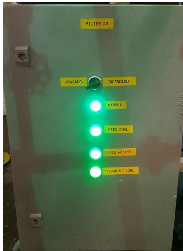
Ilustración 55: Panel operativo de compresor vilter #3
