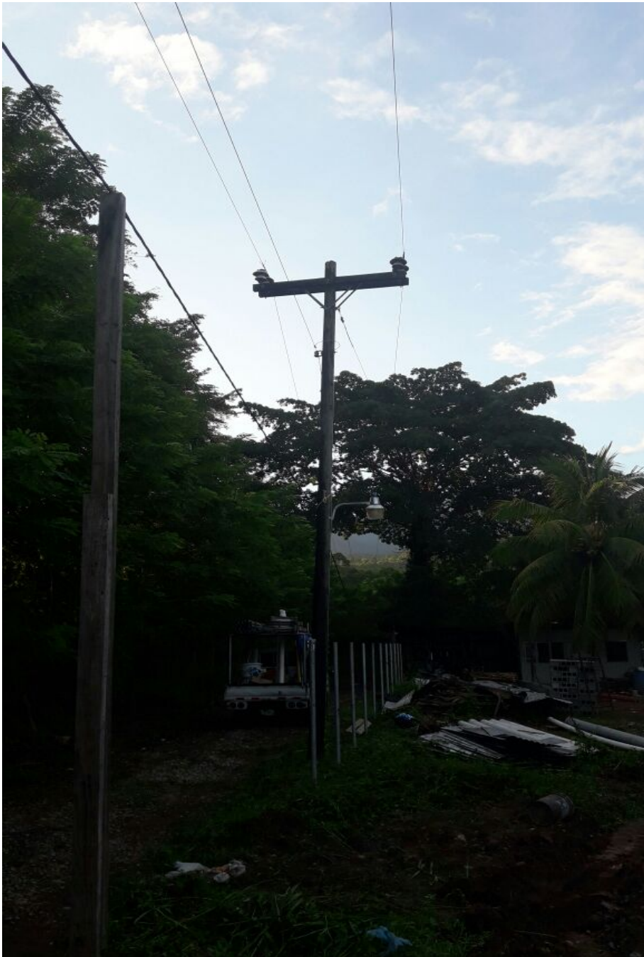
Ilustración 22 Poste eléctrico completo
