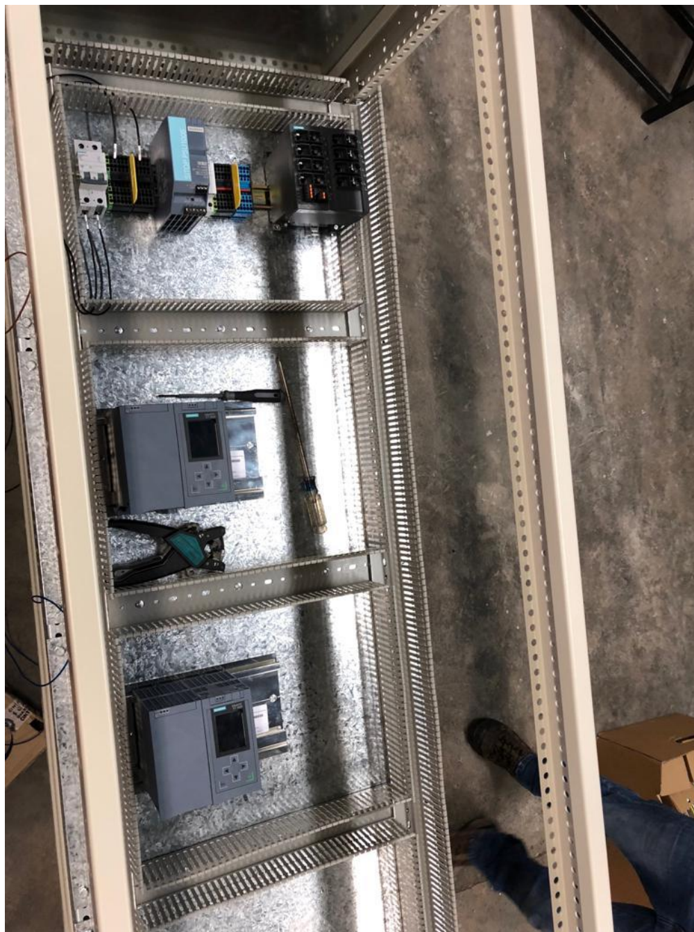
Ilustración 57: Cableado de Panel
