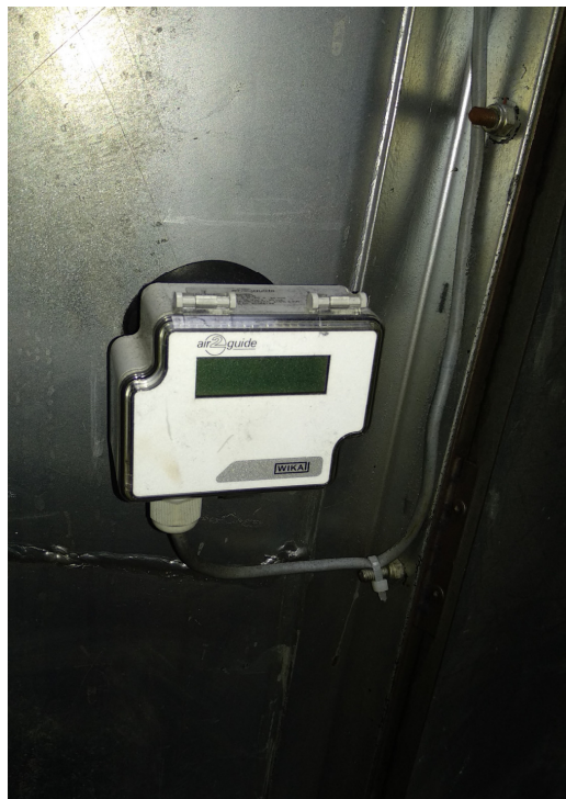
Anexo 9 - Instalación de flujómetro en ducto de entrada de aire exterior
