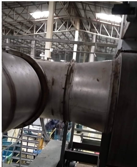
Anexo 5 - Ducto de salida de aire caliente de la secadora
