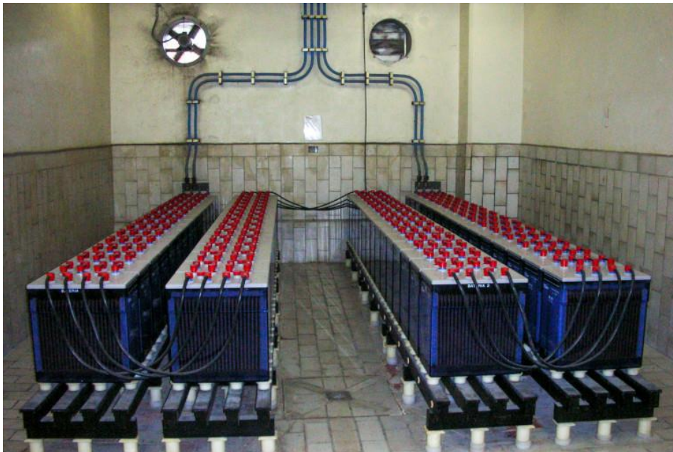
Ilustración 6- Banco de Baterías en una Subestación Eléctrica
