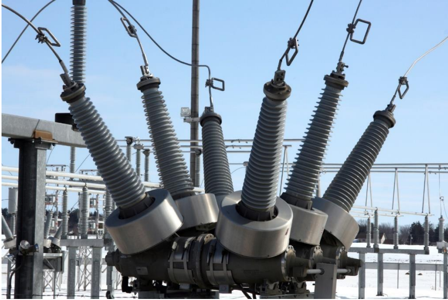
Ilustración 9- Interruptor de potencia de alta tensión
