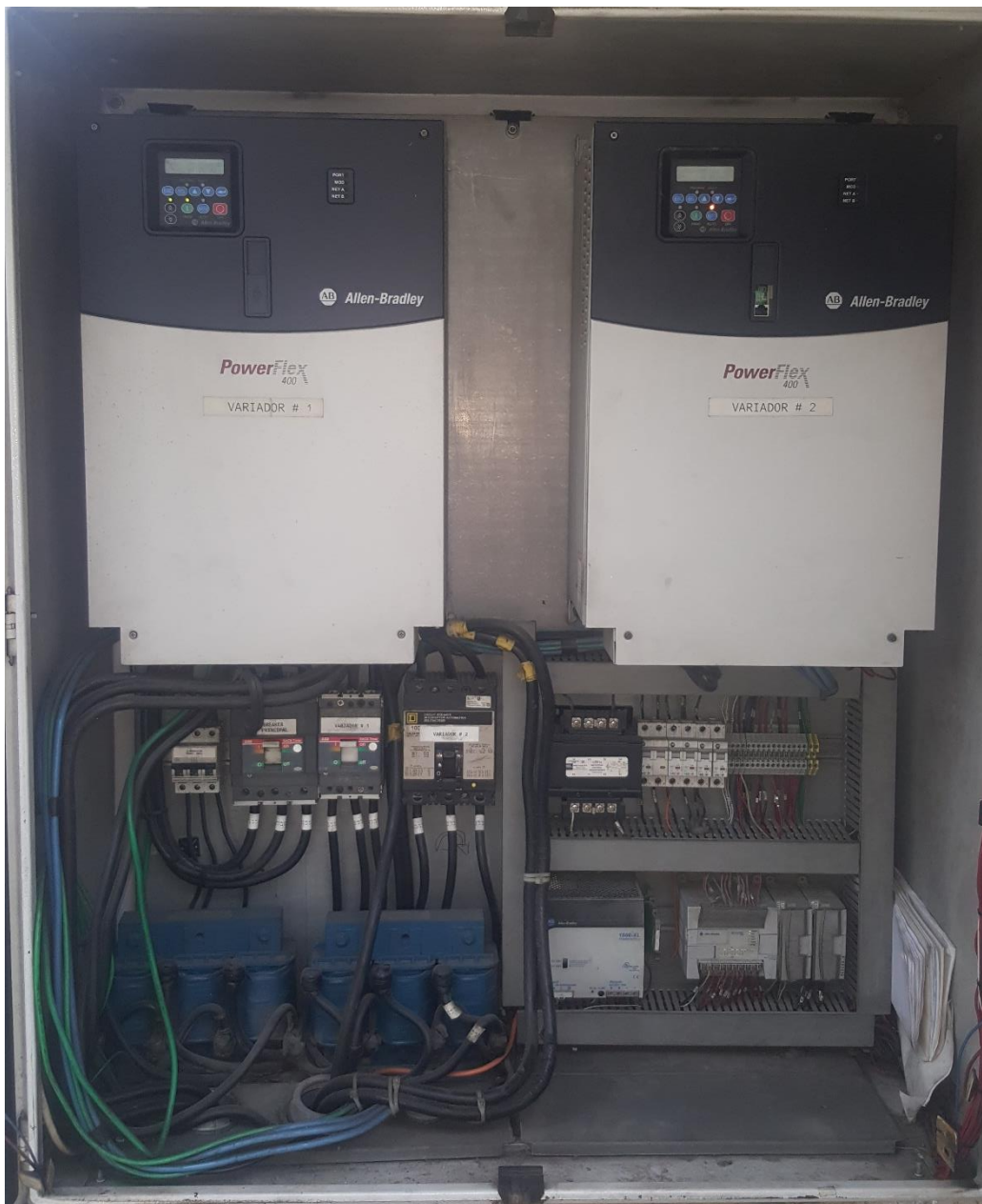
Ilustración 24. Panel eléctrico bombas booster (Antes)
