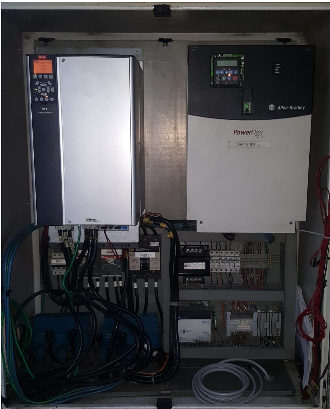
Ilustración 25. Panel eléctrico bombas booster (Después)
