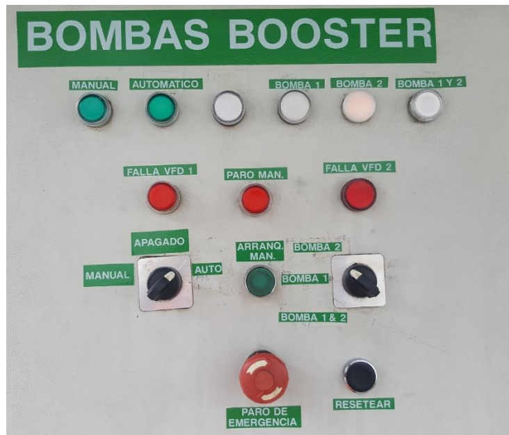
Ilustración 32. Tablero de mando en bombas booster
