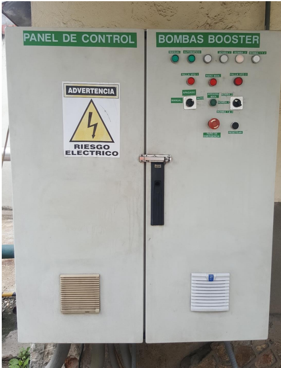
Ilustración 31. Panel eléctrico bombas booster (Vista exterior)
