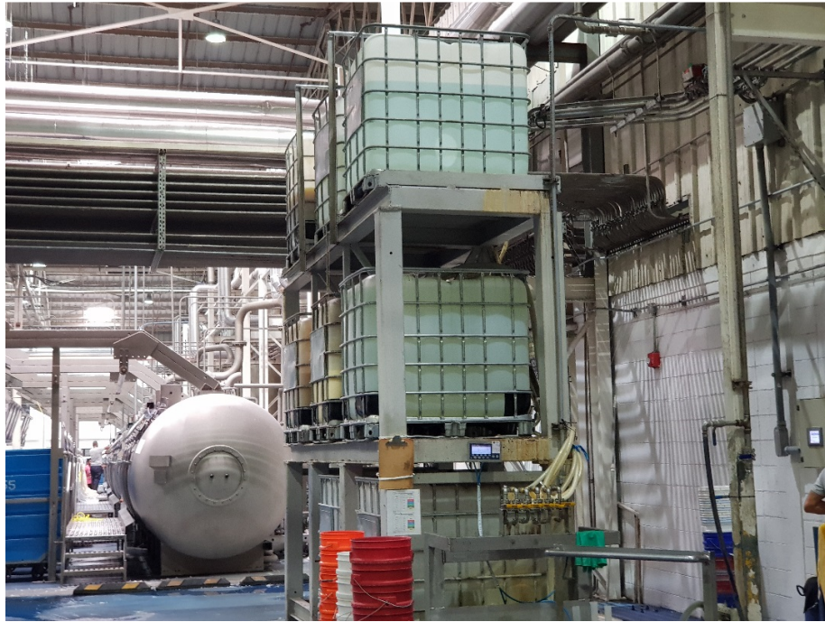
Torre de almacenamiento de químicos.
