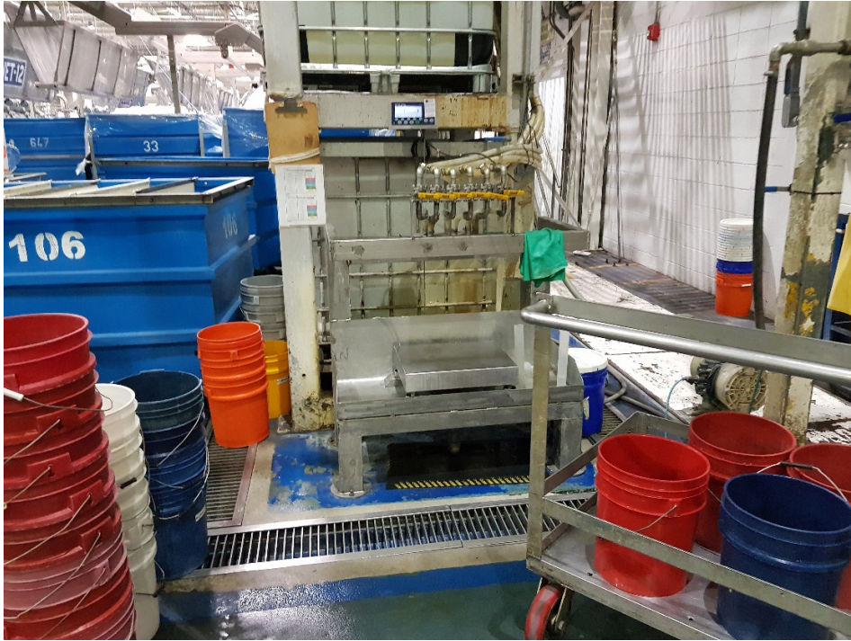
Estación de carga de químicos
