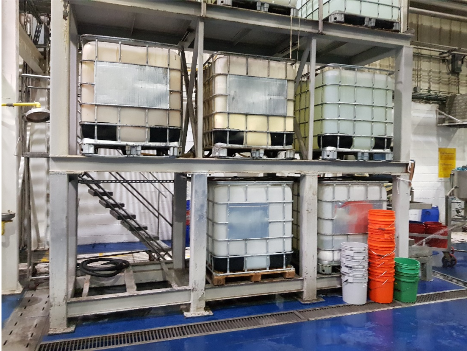
Torre de almacenamiento de químicos.
