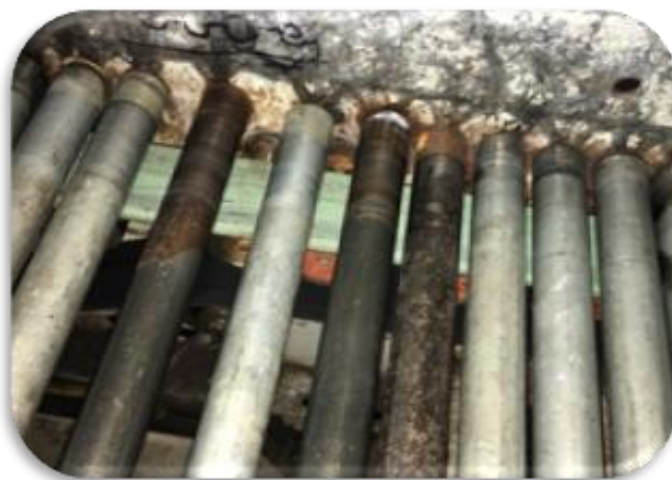
Ilustración 35. Sistema de Rodillos Mesa de Compactación
