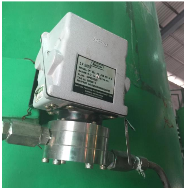
Anexos 16. Interruptor de presión diferencial instalado
