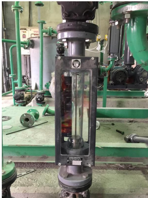
Anexos 33. Rotámetro instalado en área de lecho mixto
