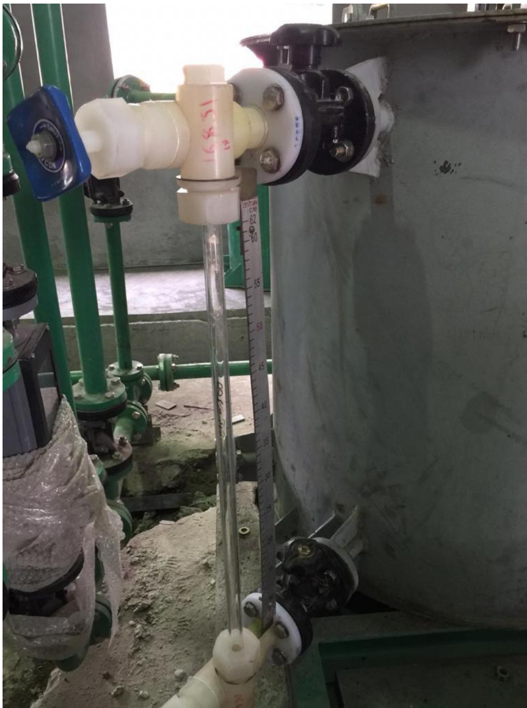
Anexos 26. Indicador de nivel local tanque de NaCl
