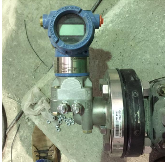
Anexos 22. Transmisor de nivel 00LITE-1 instalado correctamente en tanque de UF
