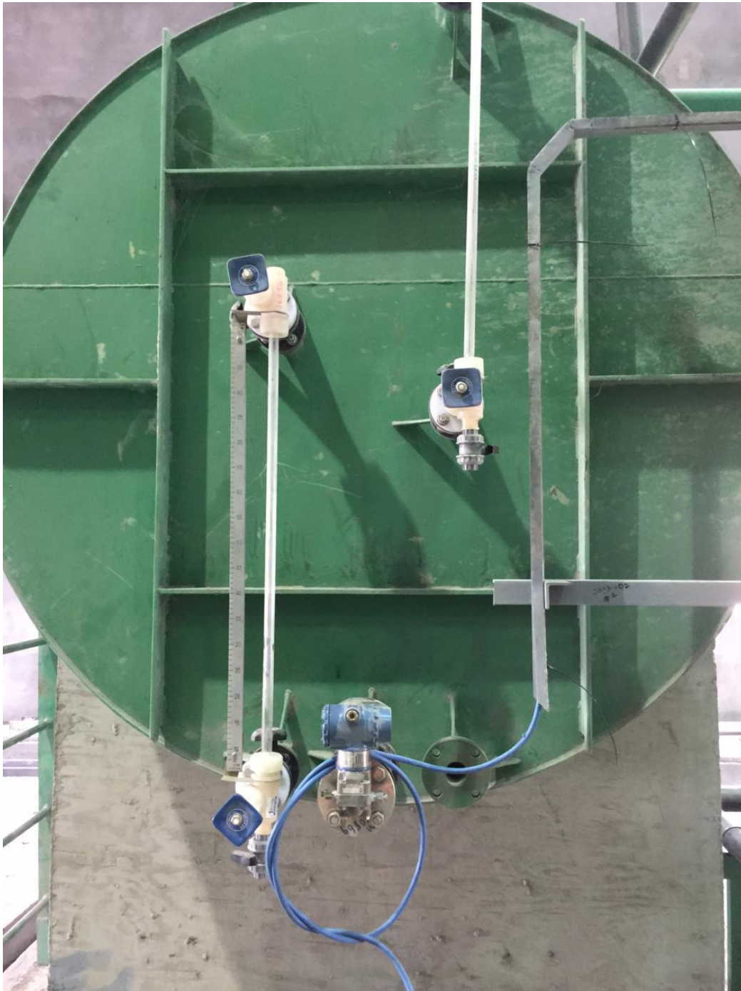
Anexos 27. Indicadores y transmisor de nivel tanque desgasificador
