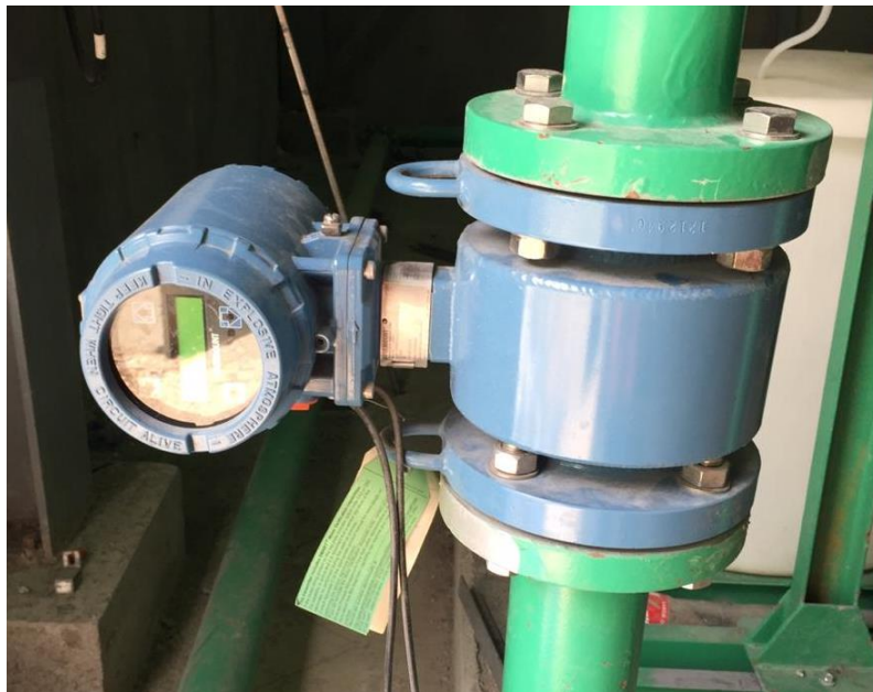
Anexos 23. Transmisor de flujo 00FMR01 instalado en el área del filtro multigrado
