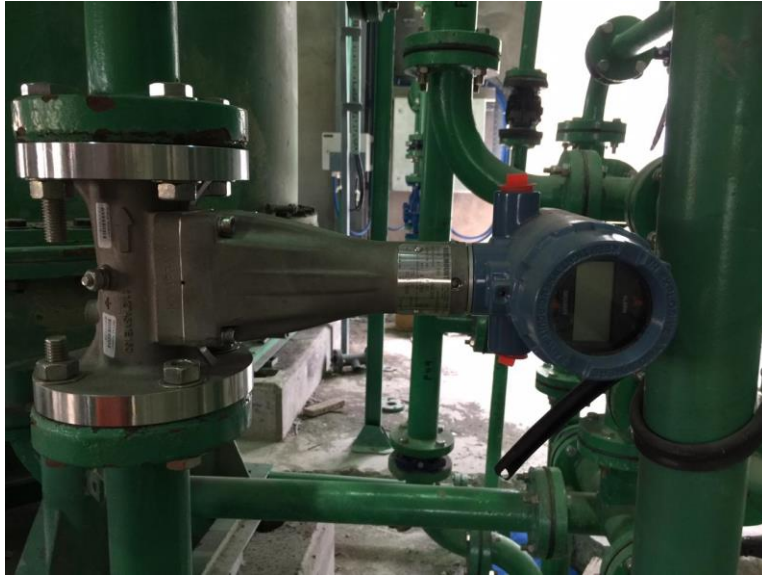
Anexos 32. Transmisor de presión instalado y cableado
