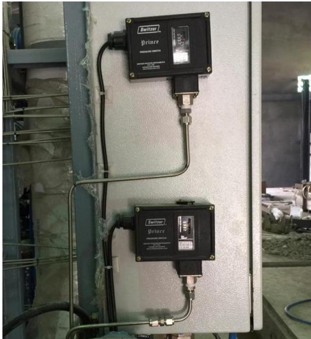
Anexos 19. Interruptores de presión baja instalados en área de UF
