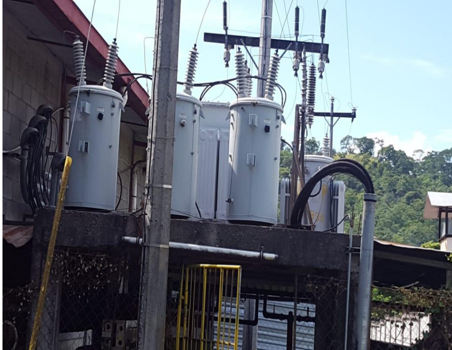
Anexo 7: Banco de Transformadores
