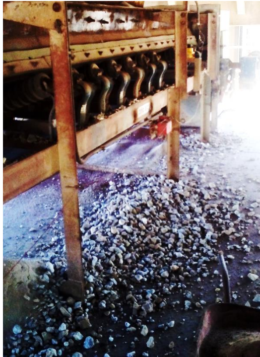
Anexo 7. Fuga de materia prima a causa de desplazamiento lateral.
