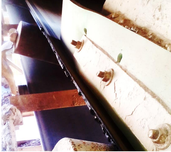
Anexo 6. Banda transportadora dañada debido a desplazamiento lateral.
