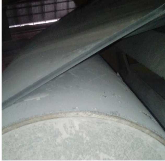
Anexo 4. Rodo motriz de banda transportadora con desgaste de caucho.
