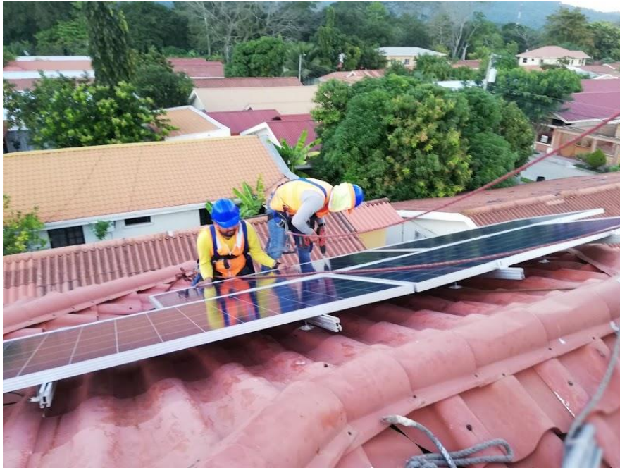
Ilustración 11 Instalación en residencia por parte de Smartsolar.
