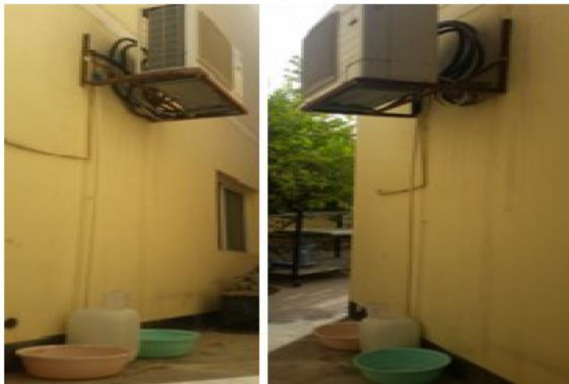
Ilustración 3 La parte exterior de la unidad split de aire acondicionado
