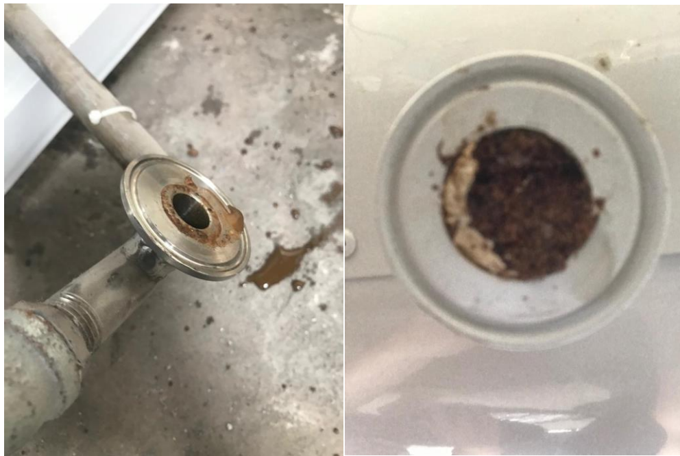
Ilustración 23. Obstrucción de tubería
