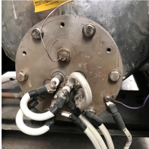
Ilustración 20. Configuración trifásica de resistencias en caldera
