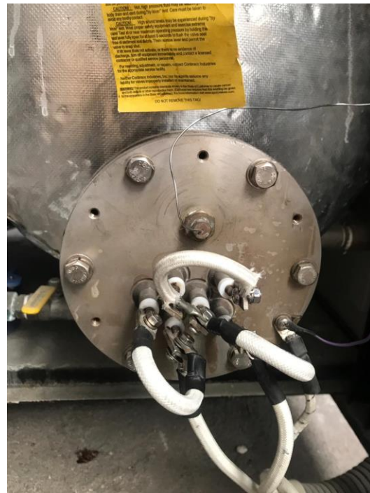
Ilustración 22. Configuración monofásica de resistencias en caldera
