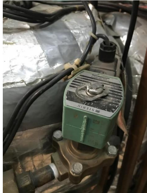
Ilustración 19. Estado actual de caldera
