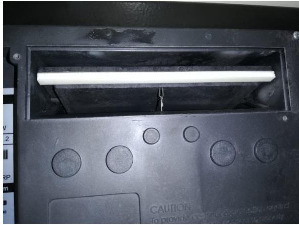
Ilustración 39. Comprobación de la ventiladora superior del deshumificador.
