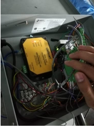
Ilustración 42. Cableado del servidor de los sensores.
