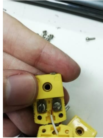
Ilustración 16. Termocupla en mal estado.
