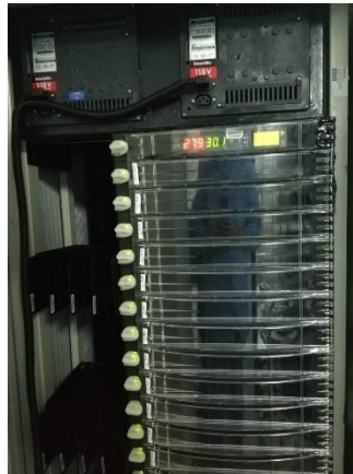
Ilustración 34. Lectura incorrecta del deshumificador.
