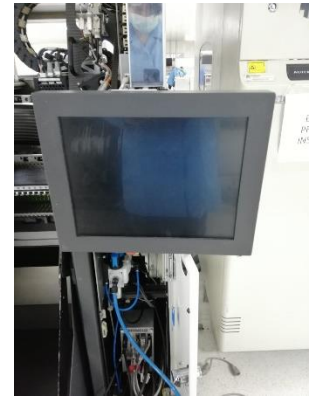
Ilustración 23. Monitor de iFlex en mal estado.
