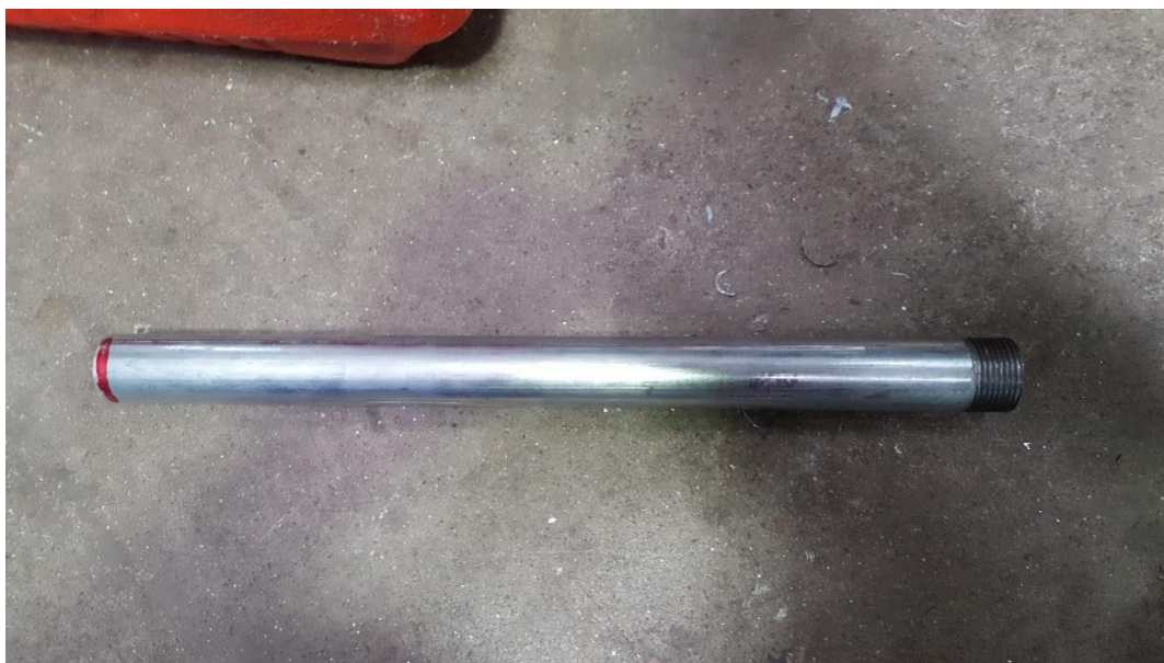
Ilustración 15. Tubería RMC de \frac{3}{4} Ø instalada
