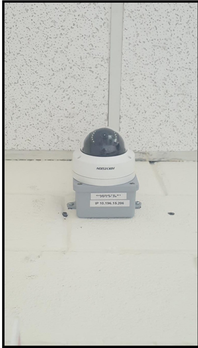
Anexo 2. Cámara domo modelo 2CD2120F-I instalada en área de IT
