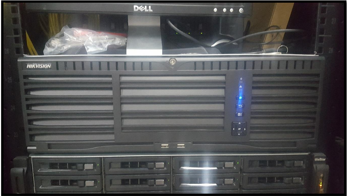
Anexo 1. NVR DS-96128NI-I16 instalado en Rack de Videovigilancia
