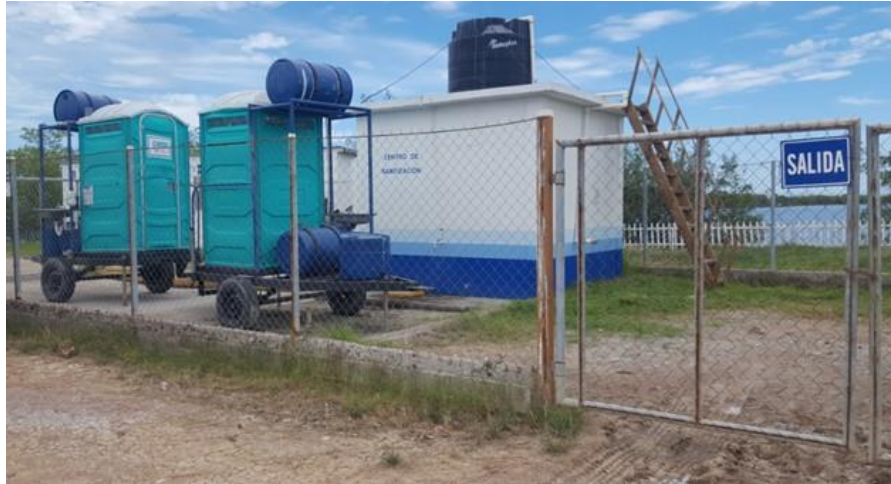
Figura 30. Vista de salida de centro de sanitización
