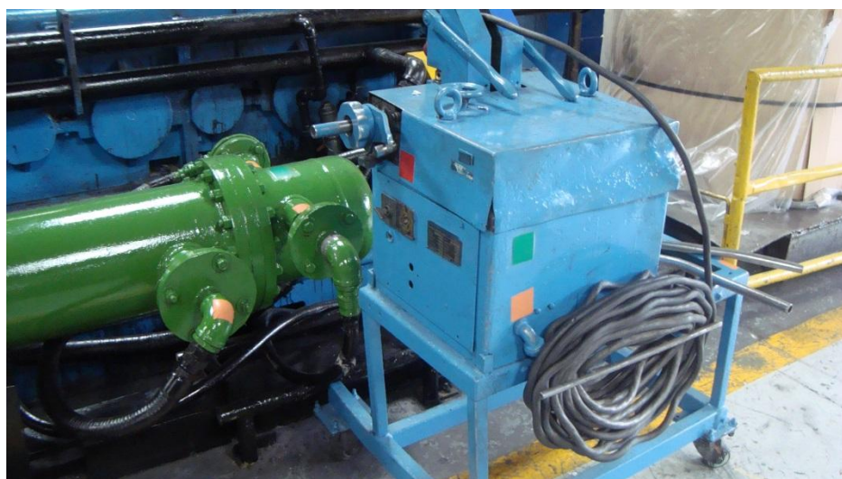
Imagen 4. Maquinas en la Planta después Implantación TPM
