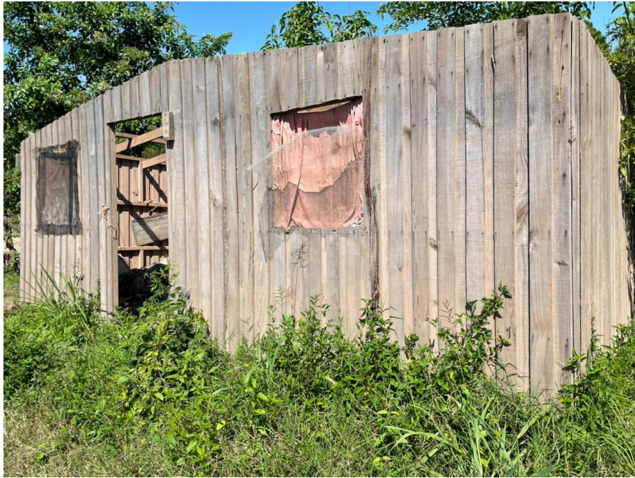
Figura 44. Estado de casa de la comunidad después de huracanes ETA e IOTA
