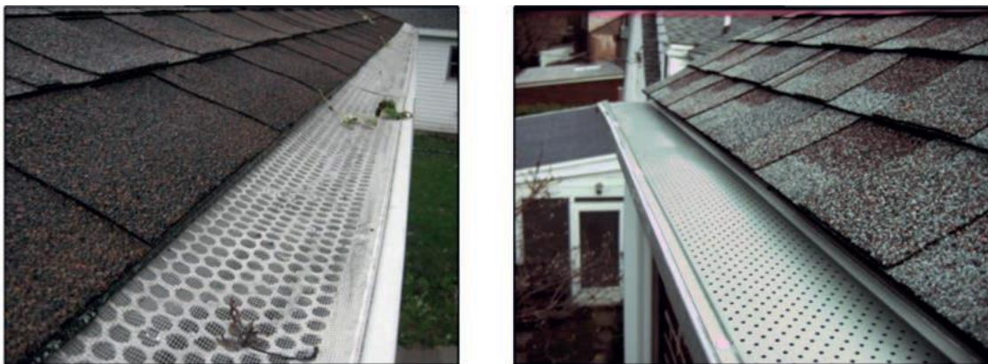
Figura 9. Filtros para evitar la contaminación del agua lluvia recolectada.
