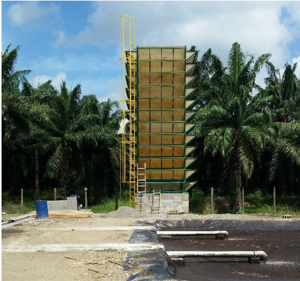
Figura 11: Torre de Enfriamiento
