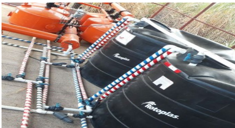
Figura 32 Sistema de mezclado de ácido y cloro.
