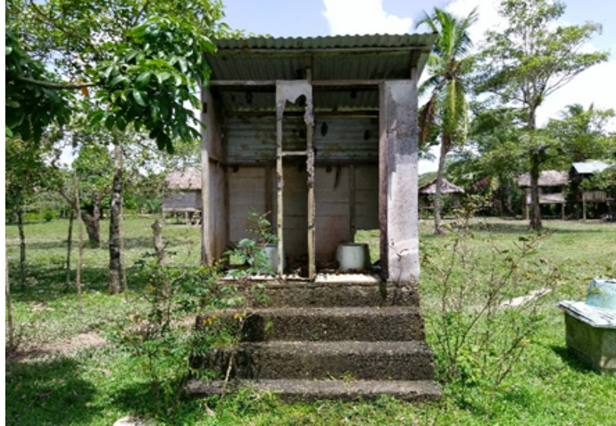
Foto 5. Módulo Sanitarios sin sistemas adecuados de recolección de aguas negras.
