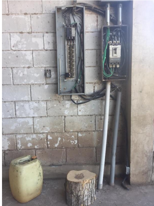
Figura 15. Situación actual falta señalización, y seguridad en instalaciones eléctricas
