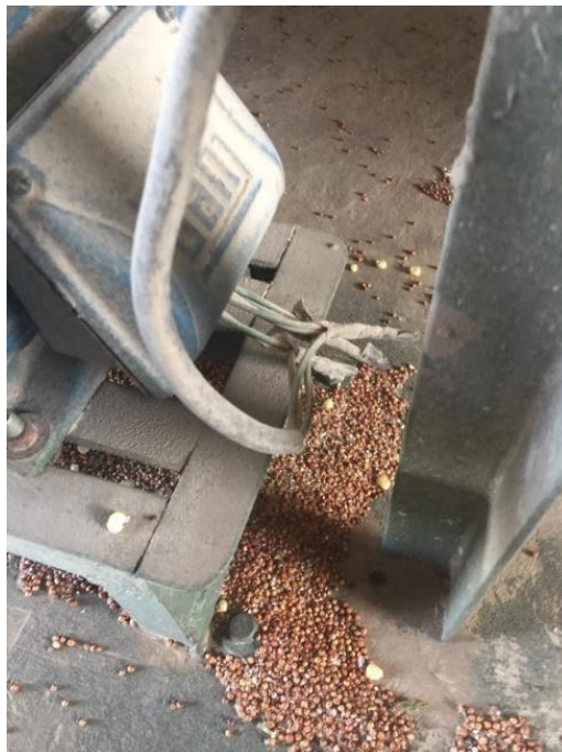
Figura 14. Situación actual falta de limpieza
