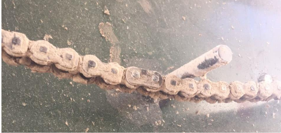
Figura 11. Situación actual, falta de lubricación en los equipos
