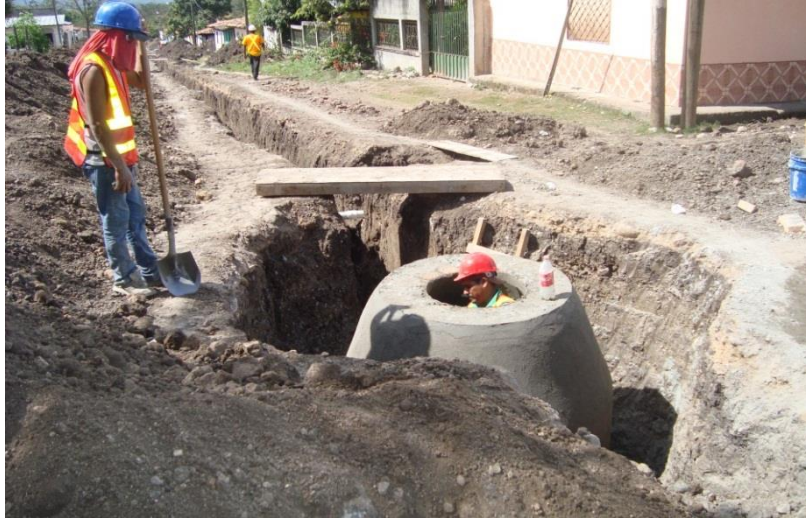
Figura 18. Construcción de Pozos de Inspección Municipio de Jesús de Otoro, Departamento de La Esperanza, Proyecto FHIS.
