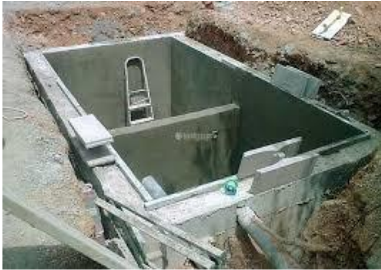
Figura 20. Fosa Séptica Tratamiento Aguas Residuales Erandique, Departamento de Lempira Proyecto FHIS.
