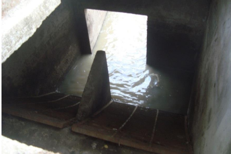
Figura 19. Pre-tratamiento Lagunas de Oxidación Municipio de La Labor, Departamento de Ocoatepeque Proyecto FHIS.
