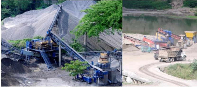
Figura 7 Planta de agregados PAYHSA
