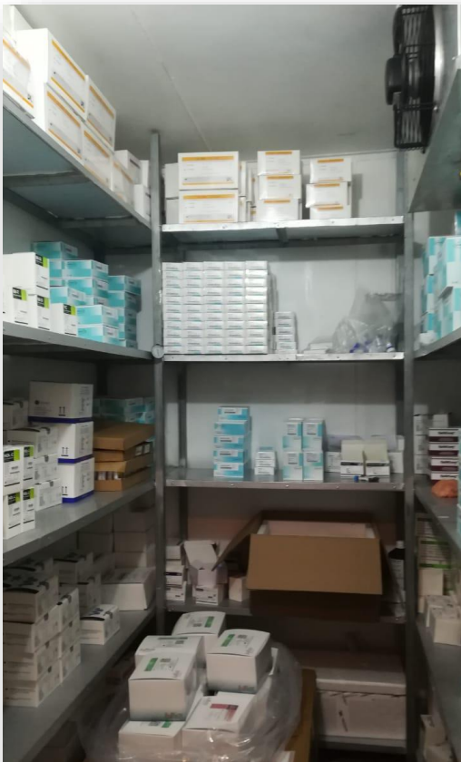
Ilustración 26. Cuarto frío controlado para mantener reactivos de laboratorio de diagnóstico clínico.
