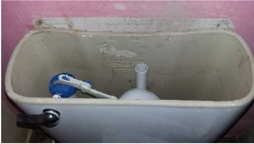
Figura 18. Tanques de sanitarios vacíos
