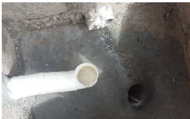
Figura 26. Caja de registro a la que se conecta la pila receptora.
