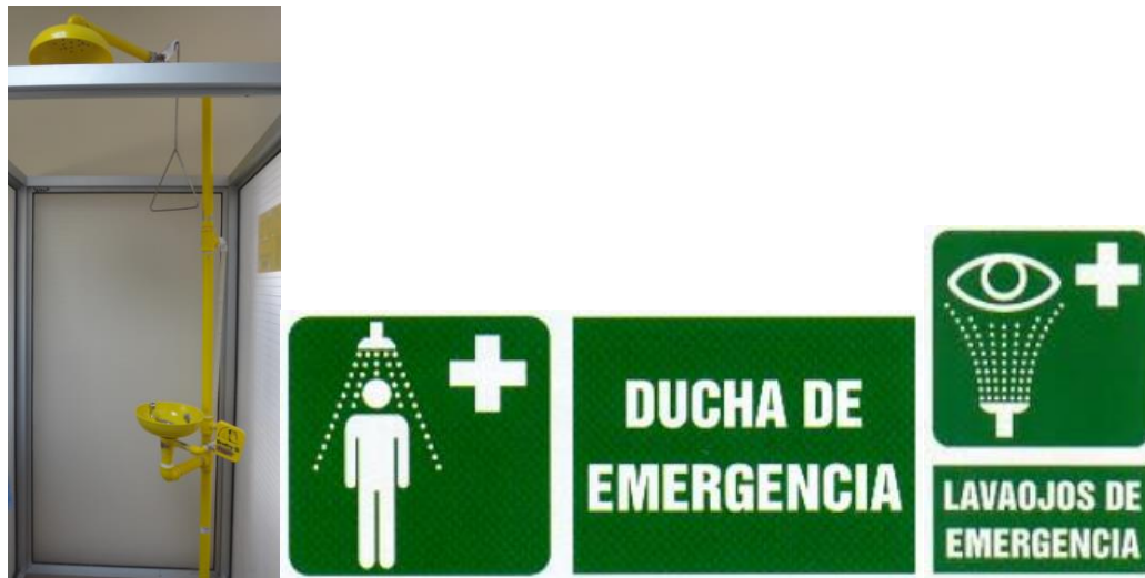
Figura 22. Duchas de seguridad
