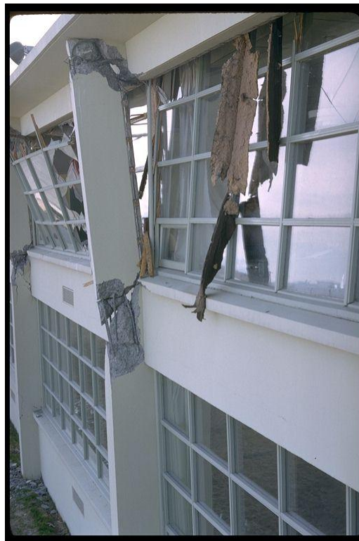
Figura 6: Daños en columnas del edificio West Anchorage High School.
