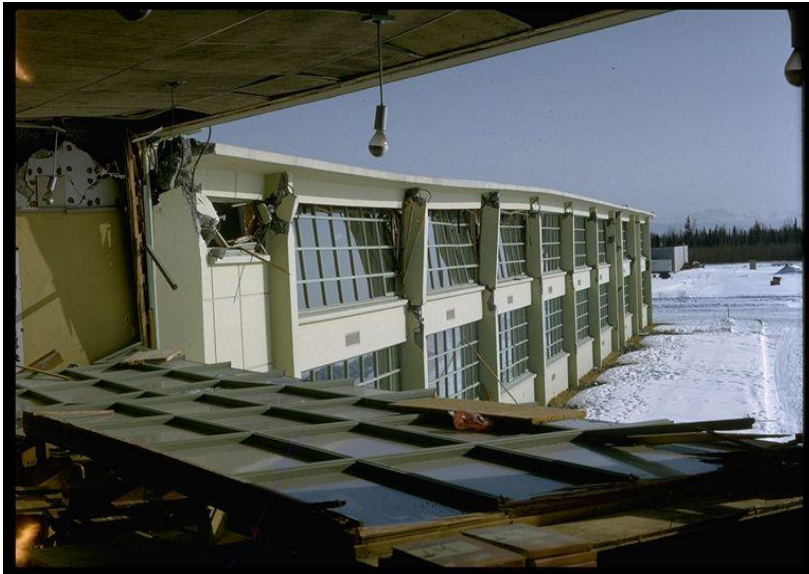
Figura 5: Daños ocasionados en Edificio West Anchorage High School.
