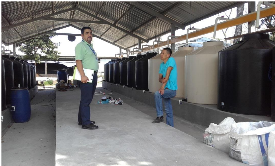
Almacenamiento de Aguas Mieles
