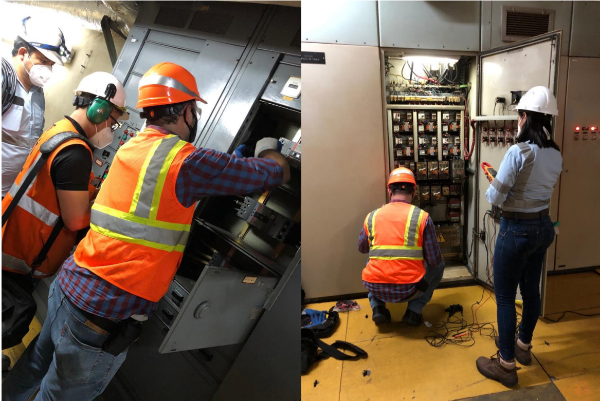
Fuente: Instalaciones de CHFM.
