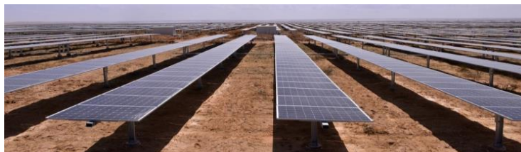
Figura 4. Planta Fotovoltaica Ningxia Yanchi Fase I
