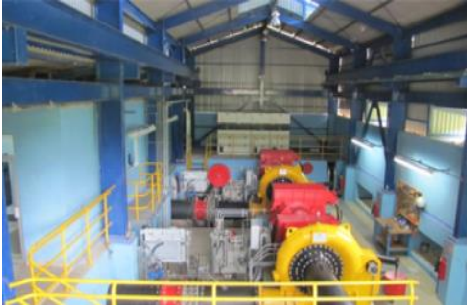
Figura 16. Casa de Máquinas Hidroeléctrica La Gloria
