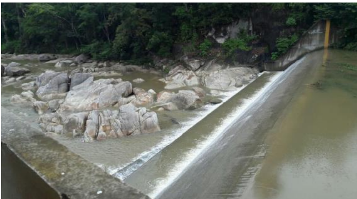
Figura 15. Salida de agua de casa de máquinas – La Gloria
