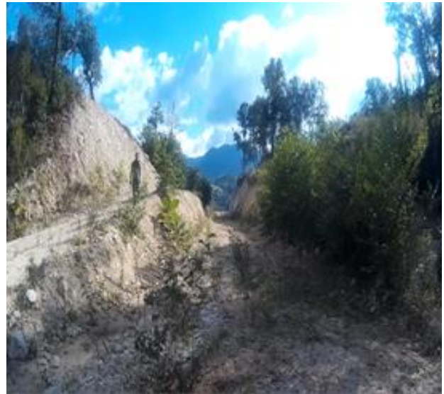
Ilustración 19. Canales de conducción en abandono
